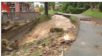
Schäden an Brückenbauwerk/Gerinne am Reichstädter Bach nach dem Hochwasser im Juni 2013
